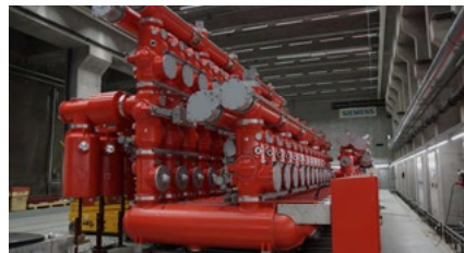
Installation GIS 420 kV montée
