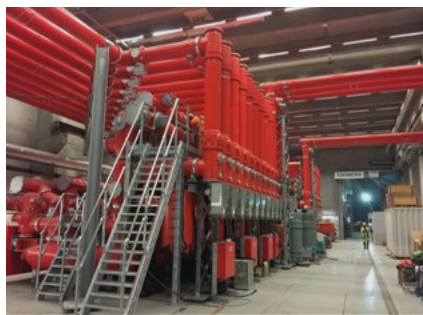
Ausleitungen 420 kV GIS
